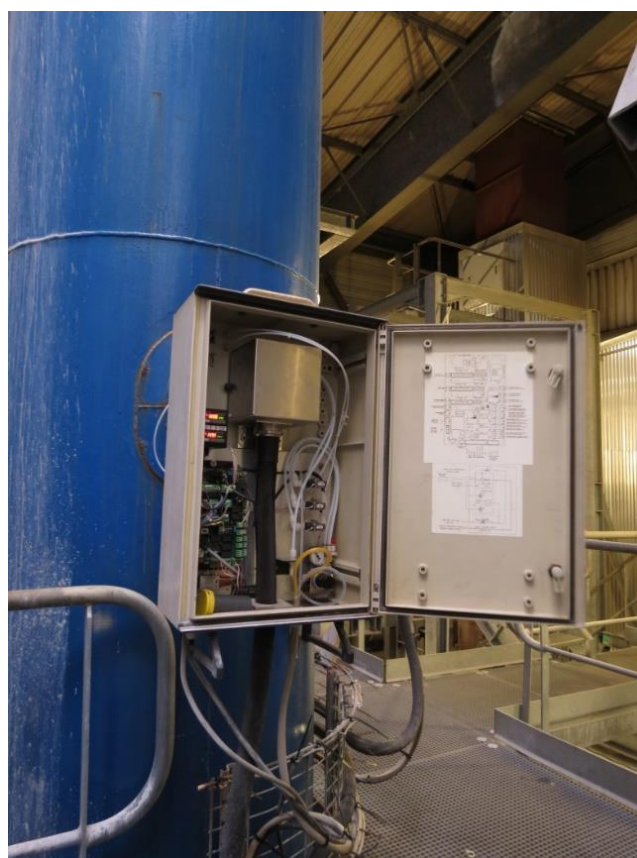
Un préleveur de fumée installé sur une cheminée
